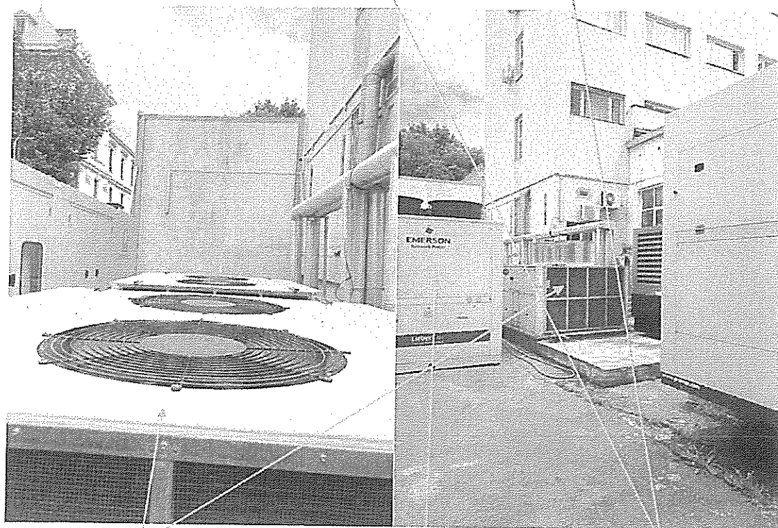
chillere generator electric Emerson (nefuncțional) Drycoolere
