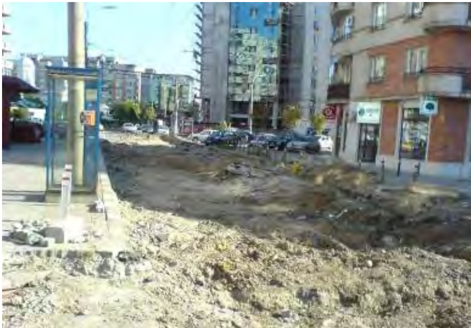
Figura 6-18 Lucrări începute și abandonate pe Strada Delea Veche
