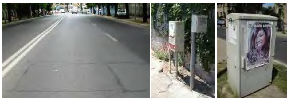
Figura 6-28 București - RATB linia de tramvai 41, detectoarele Peek SPOT UTOPIA, "adaposturi" detectoare și controlori de semnal
