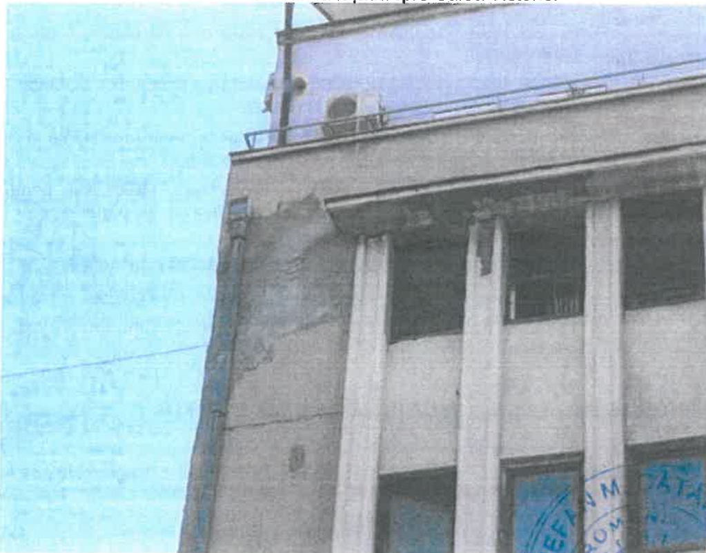
Deteriorări la fațada spre Calea Victoriei
