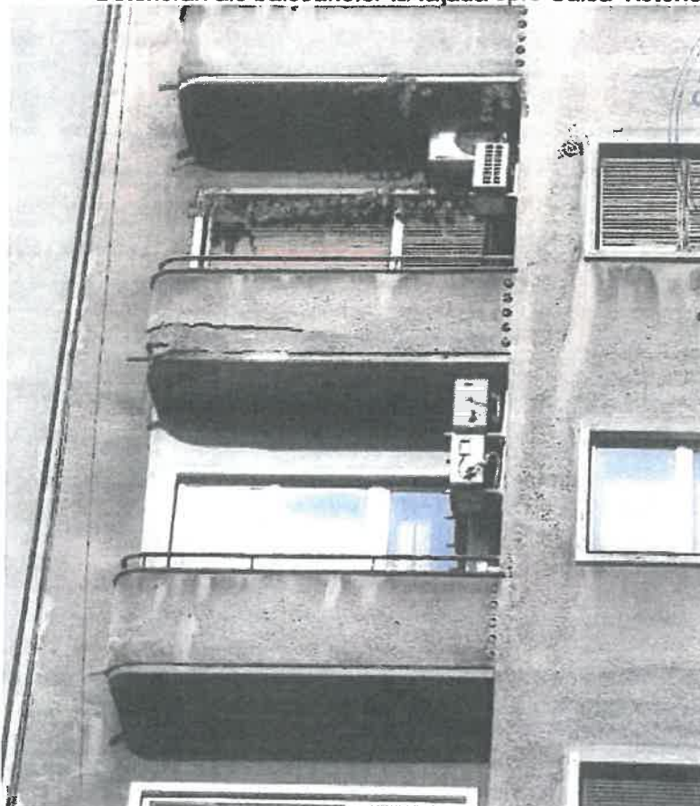
Deteriorări ale balcoanelor la fațada spre Calea Victoriei
