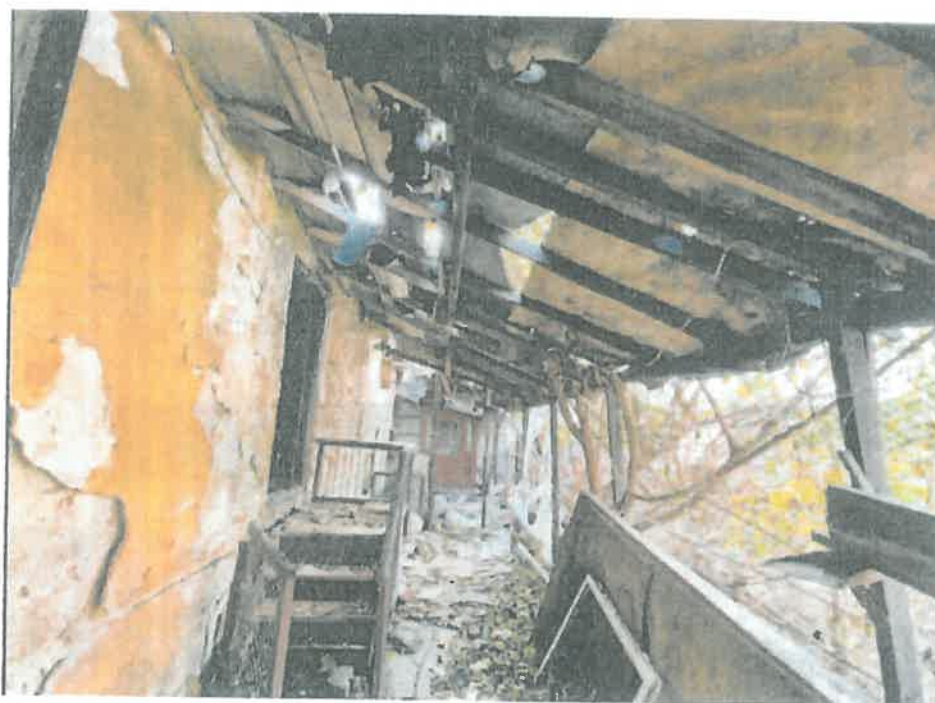
F 10 – Copertină cu structura din lemn, amplasată pe fațada de la vest și care este într-o stare avansată de degradare
