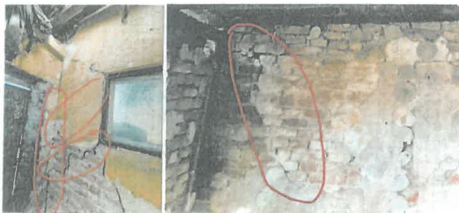
F 7 – Fisuri și crăpături în pereții de zidărie
