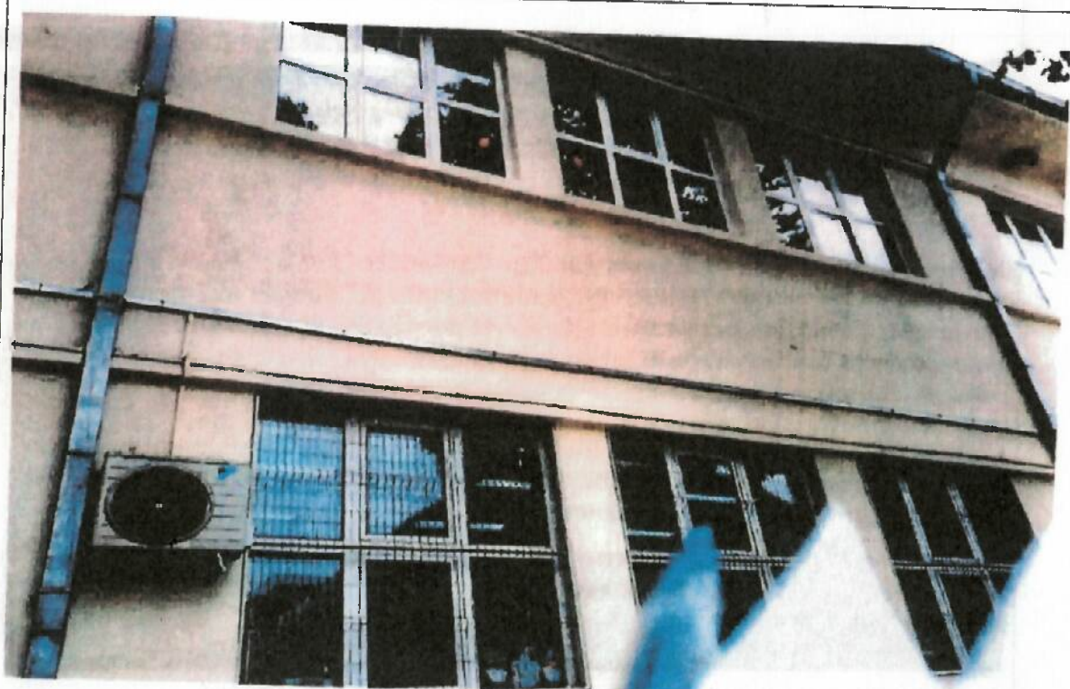
Foto 1 – Situație existentă – fisura orizontală la nivelul planșeului peste parter la corp C1-tronson B
