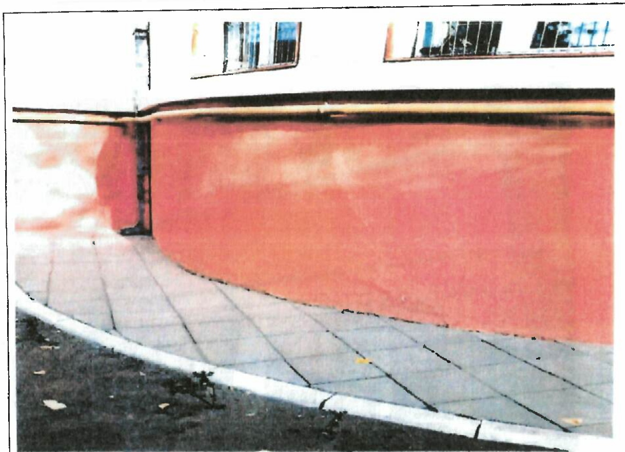
Foto 3 - Situație existentă – Fisura verticală în parapet ax A, Corp C1 – Tronson A
