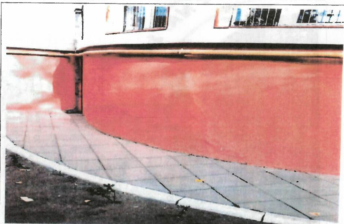
FOTO 3 - Situație existentă – Fisura verticală în parapet ax A, Corp C1 – Tronson A
