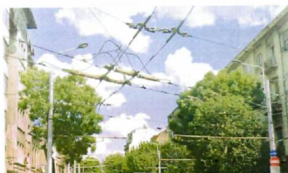
(b) Încrucișare deteriorată – M. Kogălniceanu
