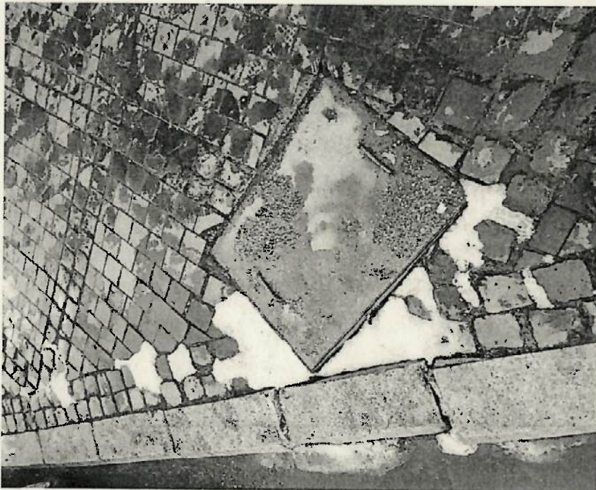
Piatră cubică și dale de pardoseală din andezit recent montate cu stereotomie și sistematizare greșite, care au dus după nici 3 ani de utilizare la desprinderea unor calupuri, a bordurilor și ieșirea din planitatea trotuarului.
