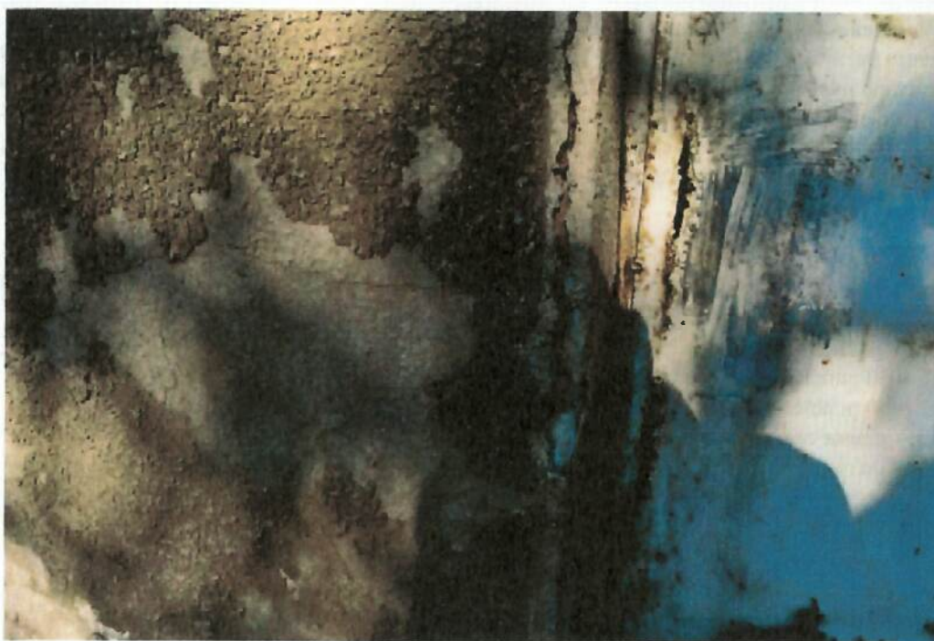
Fig. 22 Garaj (C34): Degradări ale fațadei exterioare
