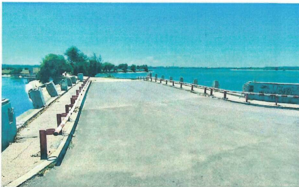
Foto 3: Vedere pod de pe rampa de acces spre dig, cale asfaltata recent, rost de dilatație acoperit cu asfalt, parapet direțional improvizat, lipsa parapet pietonal
