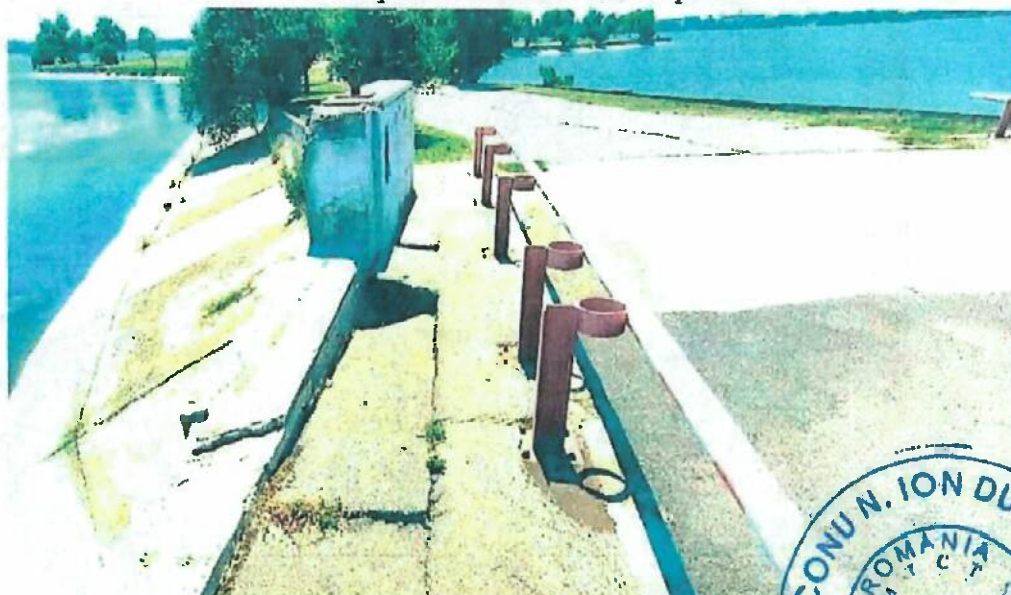
Degradare parte superioara culee Insula (trociut aval)
