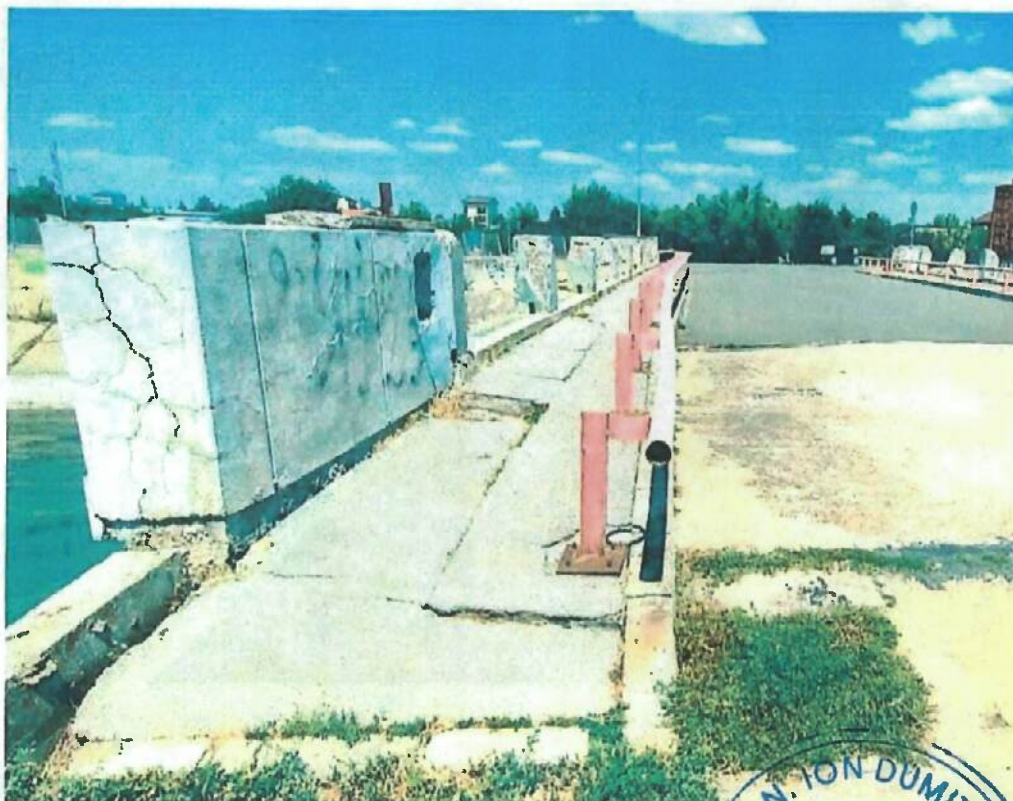
Degradare parte superioara culee Insula (trotuar amonte)
