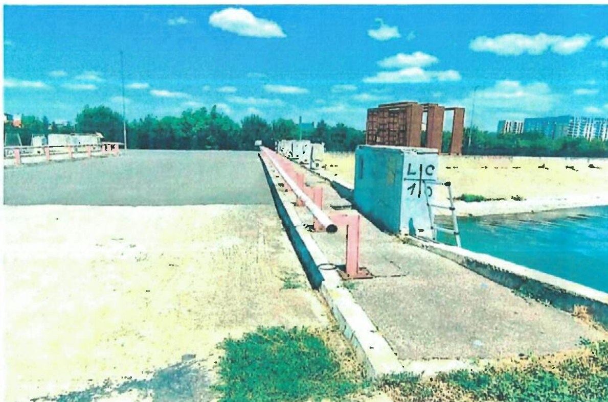
Foto 5: Trotuar si parapet aval, lipsa parapet pietonal, parapet directionaI improvizat
