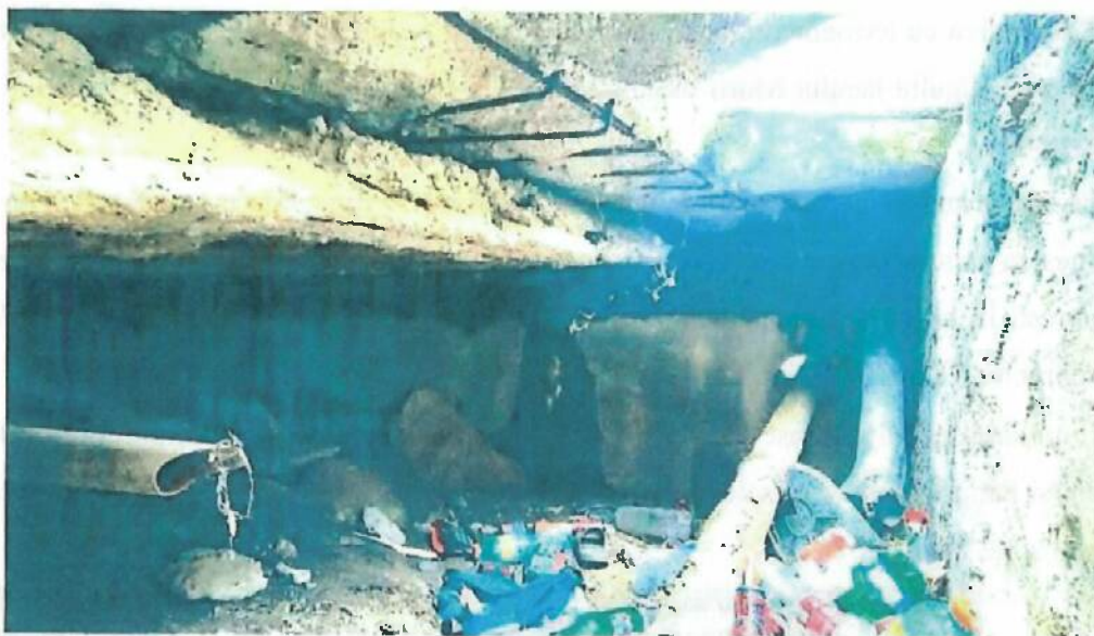
Vedere interior degradare culee insula (trotuar aval)
