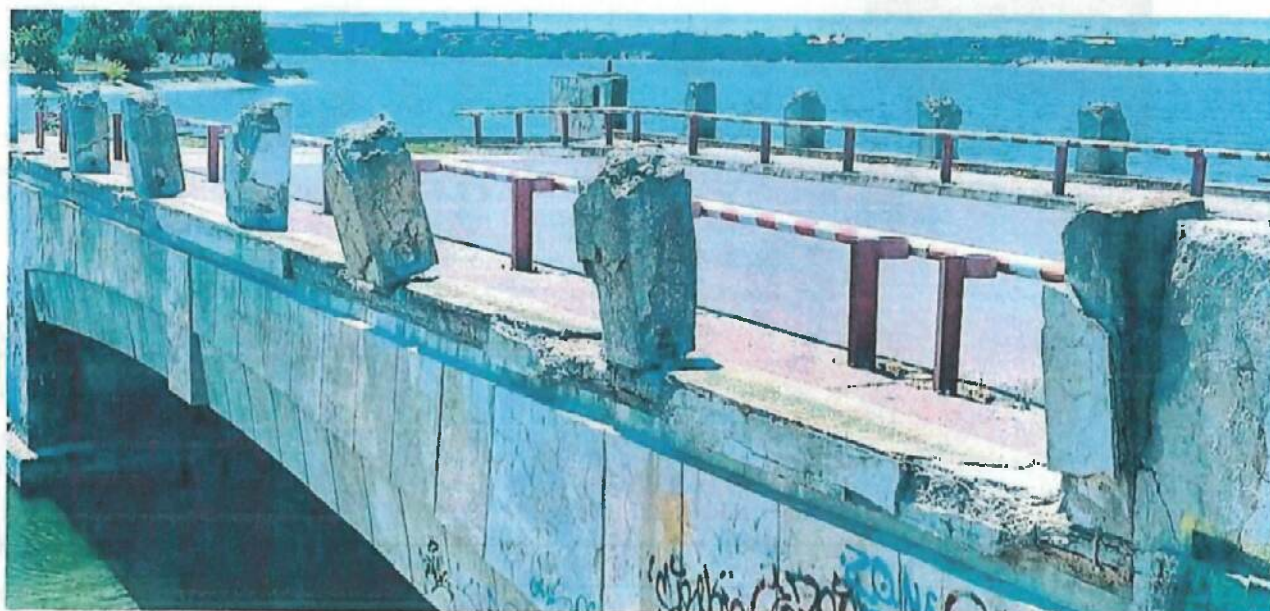
Foto 8: Stalpi din beton degradați la trotuare, lipsa parapet pietonal, parapet directionațional improvizat, cale asfaltată recent
