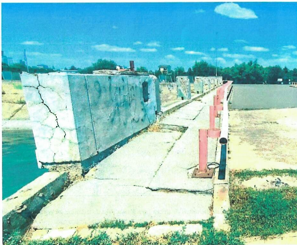
Foto 6: Trotuar si parapet amonte cu degradari, lipsa parapet pietonal, parapet directionaI improvizat
