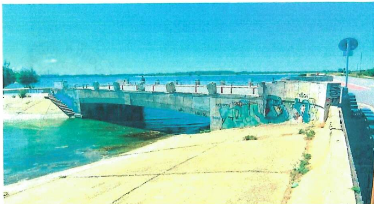
Foto 2: Vedere generala pod din aval, racordari cu terasamentele aval lipsa parapet pietonal, parapet directionațional improvizat, lipsa parapet la scara de acces sub pod în aval, spre insula
