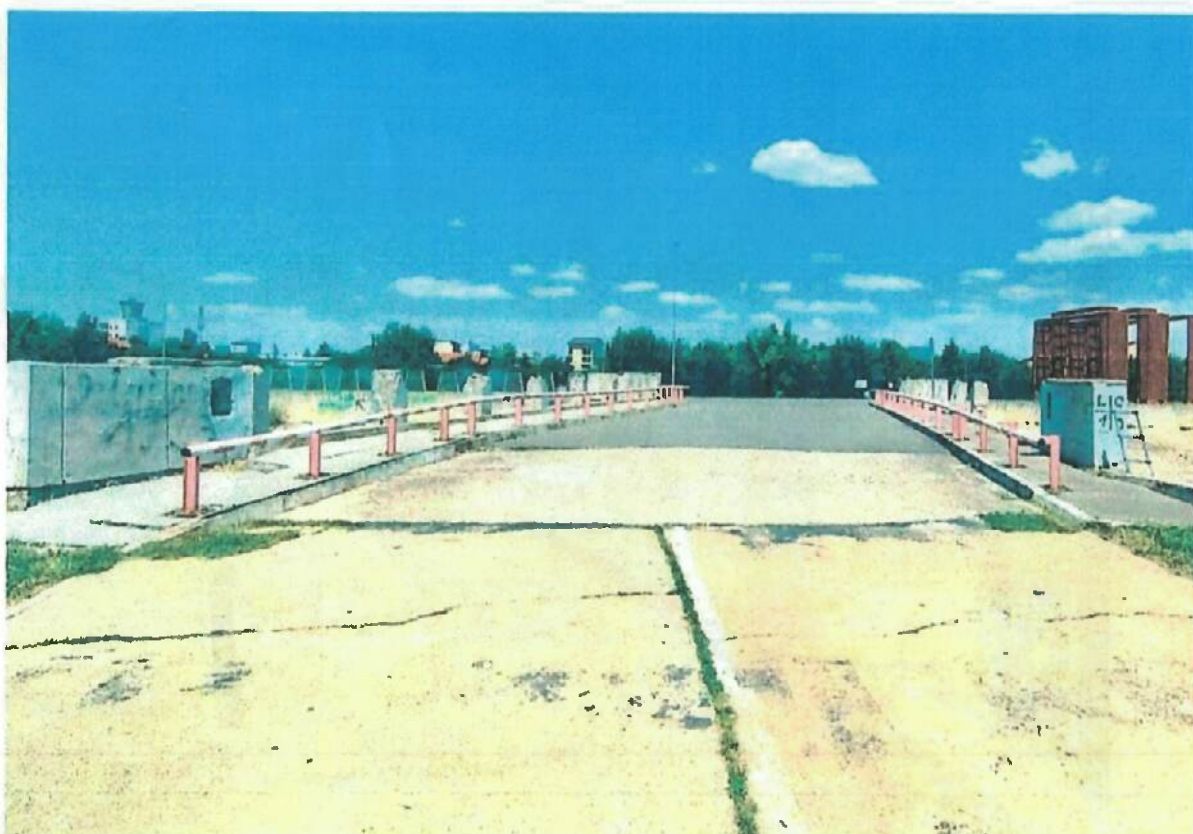
Foto 4: Vedere pod de pe rampa de acces spre insula, rost de dilatație, degradări cale rampa, lipsa parapet pietonal, parapet direțional improvizat
