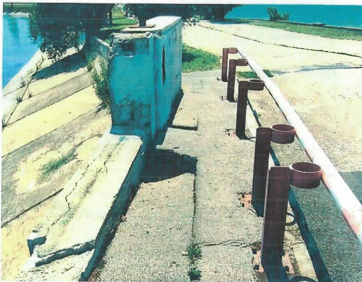
Foto 7: Degradare cale trotuar aval pe zona culeei, lipsa parapet pietonal, parapet directionațional improvizat
