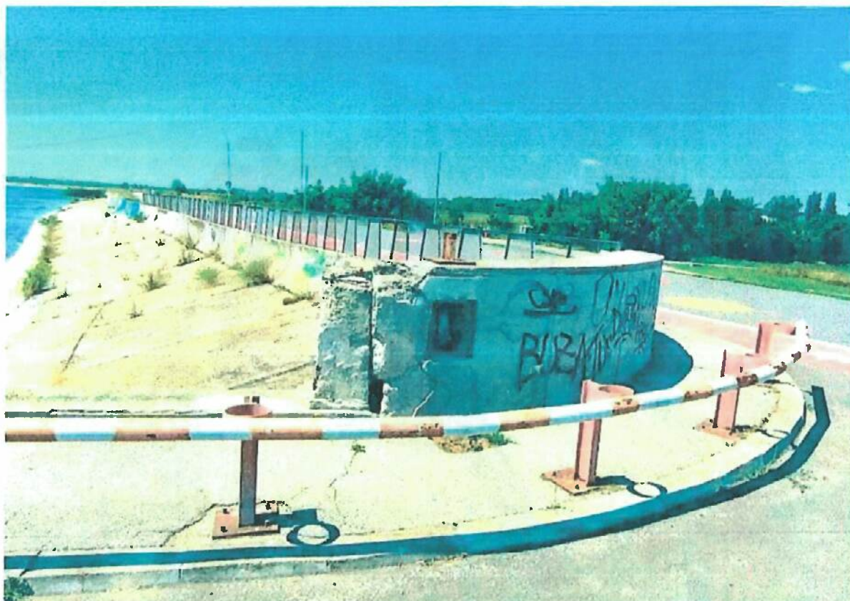
Foto 9: Stalpi de iluminat lipsa si legaturi electrice expuse, parapet directionațional improvizat, lipsa parapet pietonal
