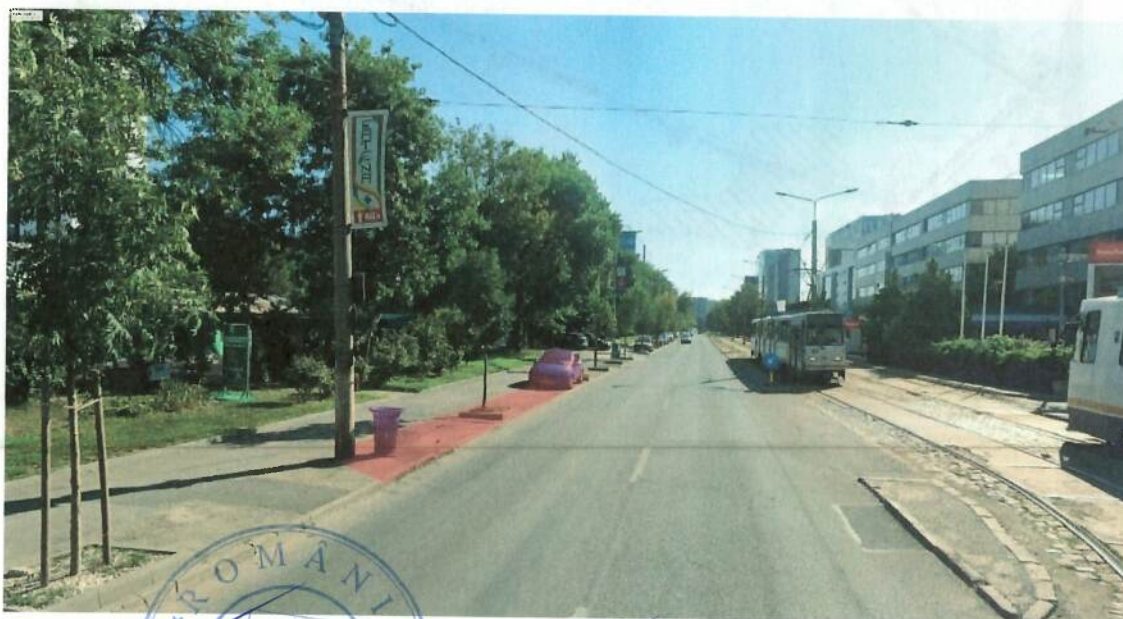
Figură 51 - Fotografie care ilustrează starea stației de autobuz Platforma Pipera spre strada Gara Herăstrău
