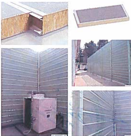
Izolarea fonică a echipamentelor exterioare cu ajutorul panourilor fonoabsorbante
