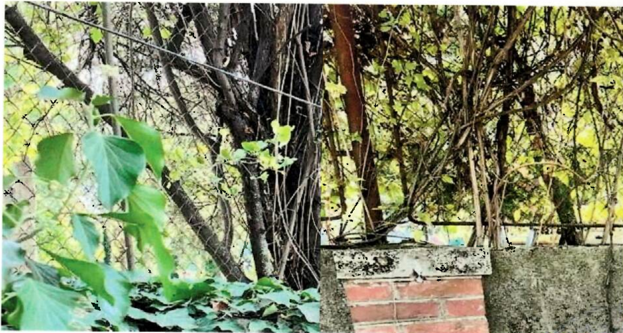
Panou de gard degradat
