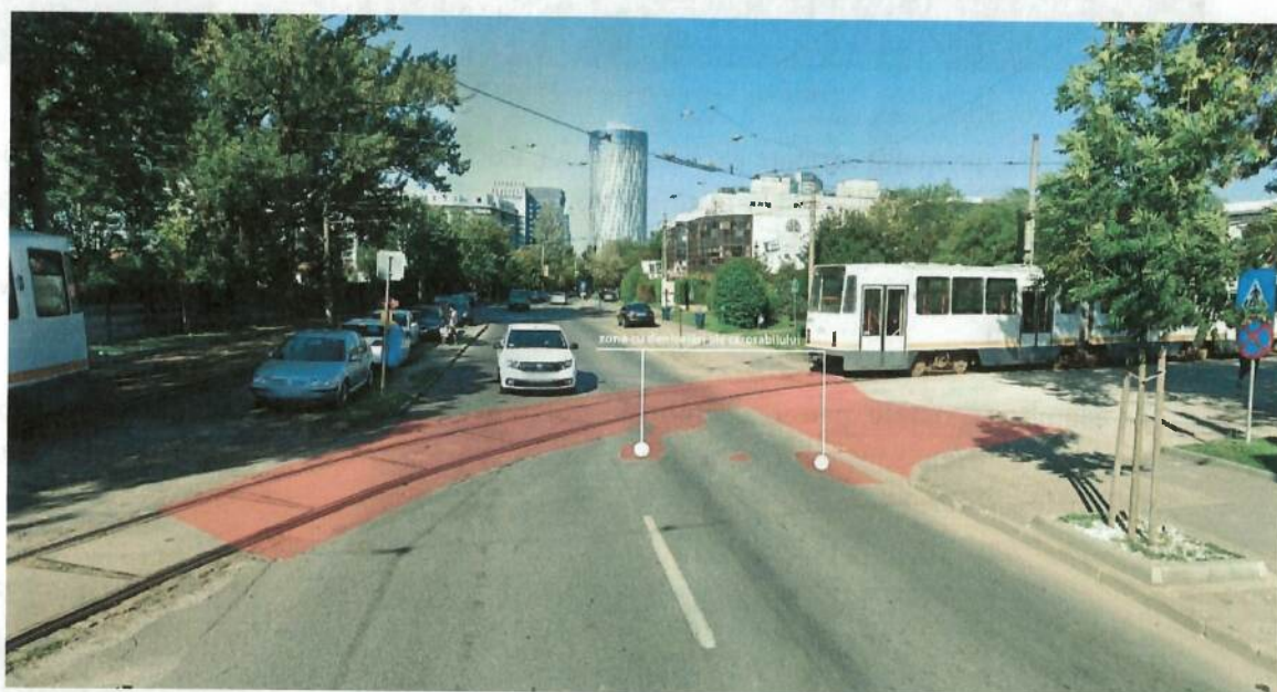
Figură 12 - Imagine care ilustrează starea tehnică a b-dului Dimitrie Pompeiu în dreptul intersecției cu calea de tramvai
