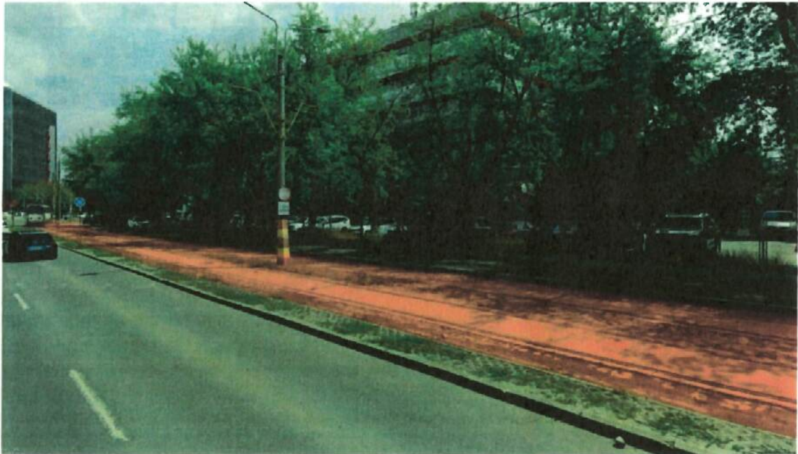
Figură 40 - Starea tehnică degradată a liniilor de tramvai de pe b-dul Dimitrie Pompeiu
