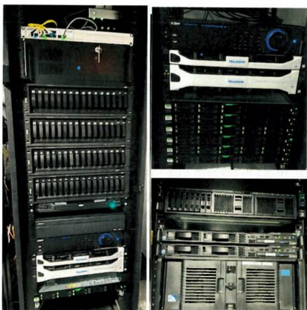
Fig.2.3.5.2 Serverele si stocarea aferenta sub-sistemului de supraveghere video
