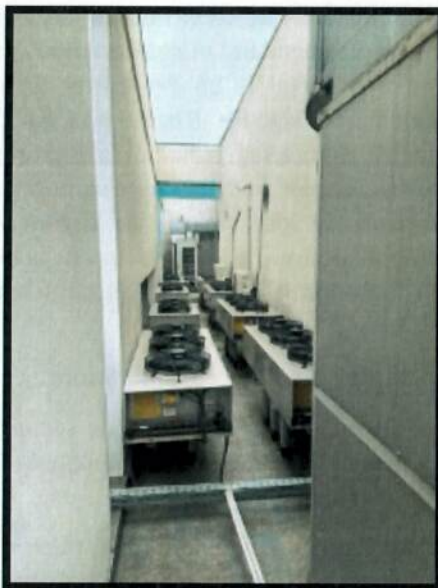
Fig. 3.2.1.7.13 Linia de agregate de climatizare – implementat la sediul CMISU
